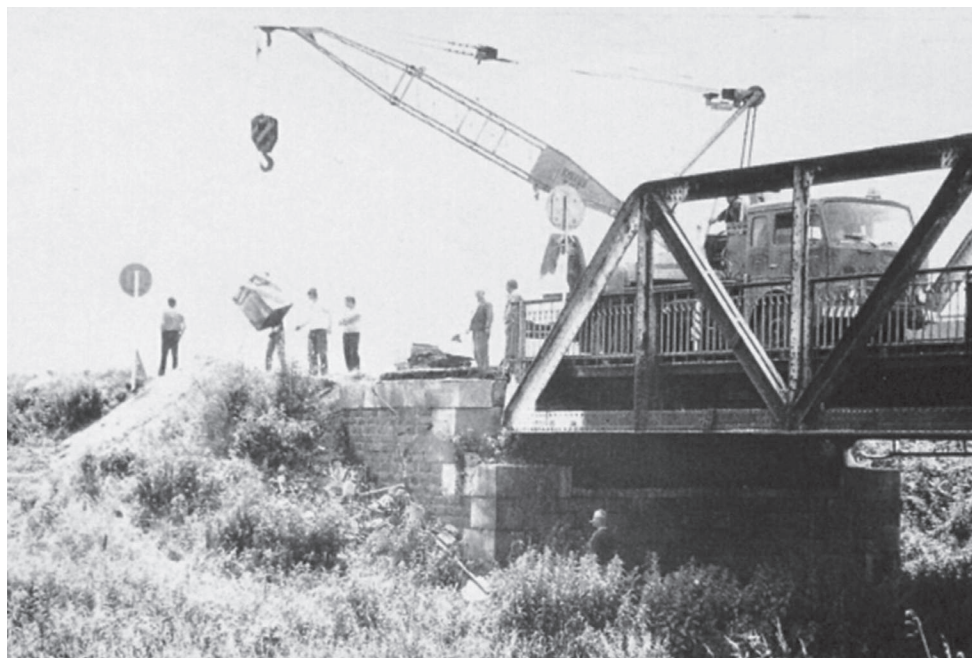
TROCHA HISTORIE | Most zvaný železný přes řeku Moravici (postavený 1912 - 1913) na silnici Komárov – Opava (FOTO 1, záběr z roku 1946). Oprava římsy železného mostu v roce 1989 (most sloužil až do roku 1994, FOTO 2). FOTO ARCHIV KOMÁROVA
