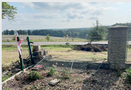
Hřbitovní zeď v Podvihově před rekonstrukcí a po.
