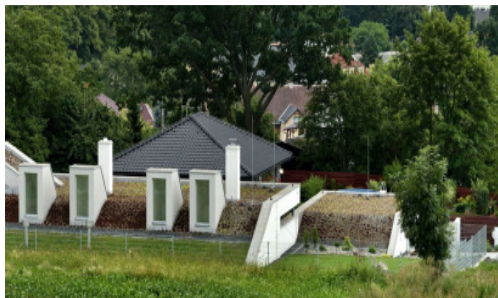
Šikmá extenzivní střecha – obytný dům Jaktar (foto: Ekotoxa)
