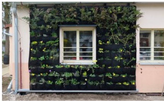
Vertikální zahrada na budově firmy Liko-S ve Slavkově u Brna pokrytá nerezovými kazetami s mokřadními rostlinami v porézním substrátu s bakteriemi pro čištění odpadních vod (zdroj: www.zelenafasada.cz)
